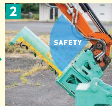
2 落下防止の角度センサーで安全
